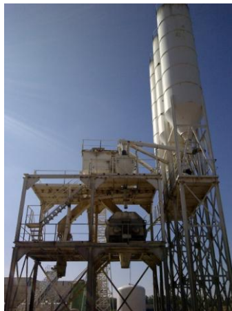
Figura 1.- Central de Fabricación de Hormigón con doble vía (seca y húmeda).
